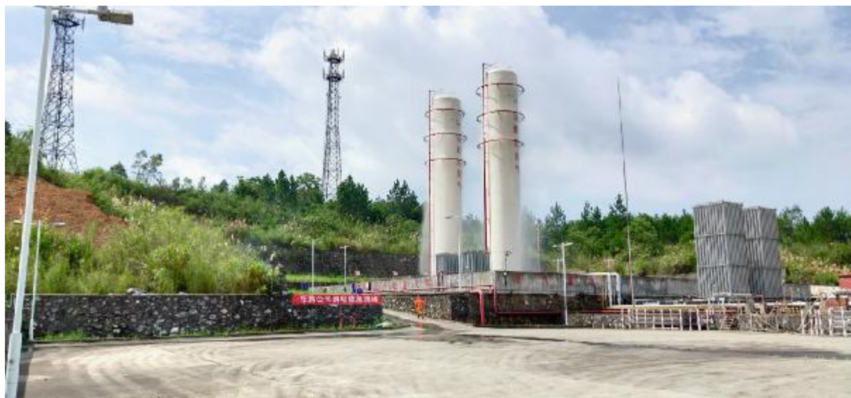
图 3.2.1-3 乐昌工业园区 LNG 气化站
