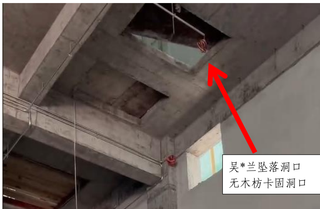
图 1：2025 年 6 月 11 日事发当日，吴*兰坠落时 2#原粮清理车间 2 层洞口原状
