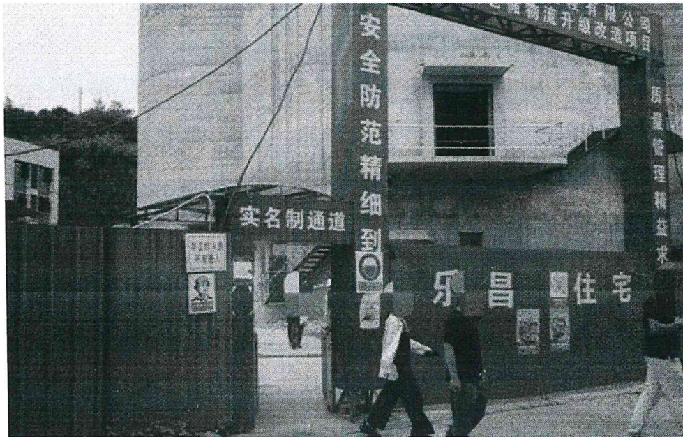
图 4:2025 年 6 月 19 日工地主进出口（未设置门卫值班室 [3] ）
