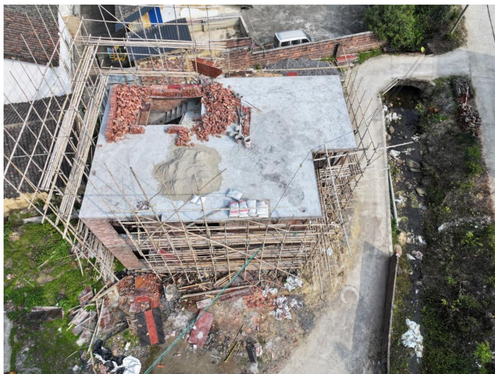
图1 事故自建房现场图
