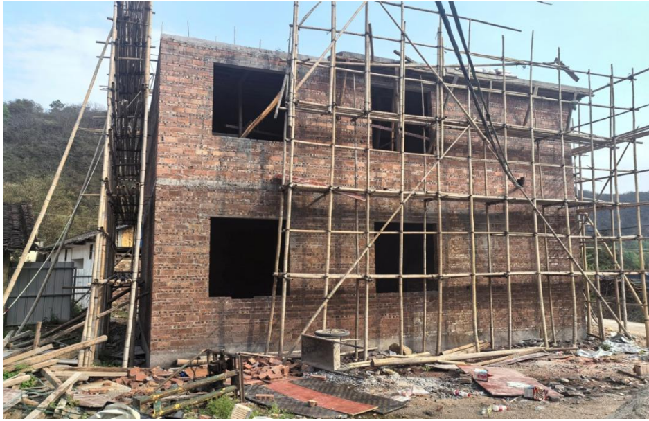
图 4 事故自建房现场图
